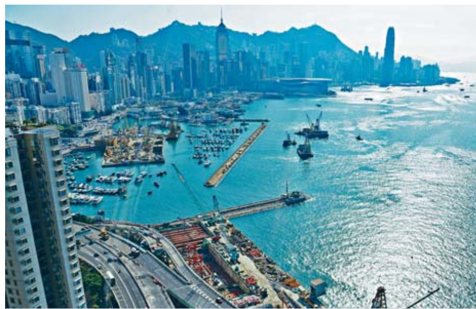
近年本港不少基建工程都出現超支情況，如中環一灣仔繞道，就因為石層位置進行地質勘探出現誤差，令工程成本增加十億元。資料圖片
